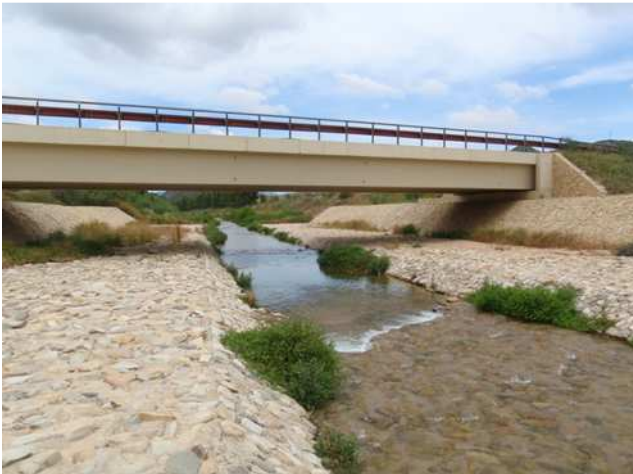
Site view/Channel – Corr'e Pruna Ponte, 20/05/2011.
