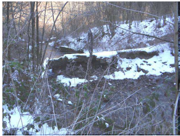
Vista da monte della traversa in disuso. Il "petto" è stato sottoescavato per aggiramento dell'opera.
